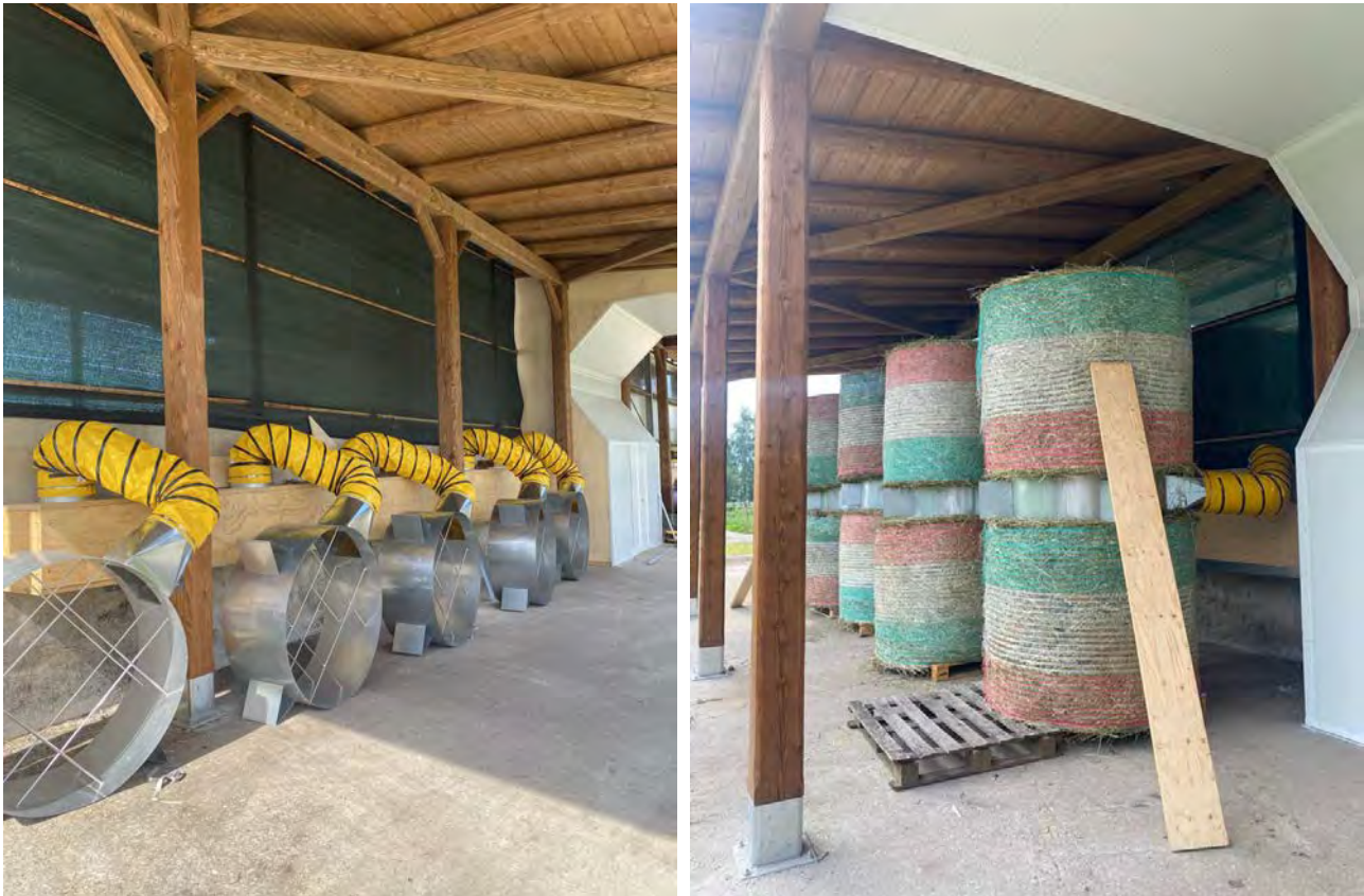
Figura 8. Piattaforme idonee al posizionamento di due rotoballe che sono essiccate dall'aria riscaldata e insufflata verso l'alto e verso il basso, spinta dal ventilatore radiale (a sinistra, piattaforme non in esercizio; a destra piattaforme in fase di essiccazione di due rotoballe ciascuna).
