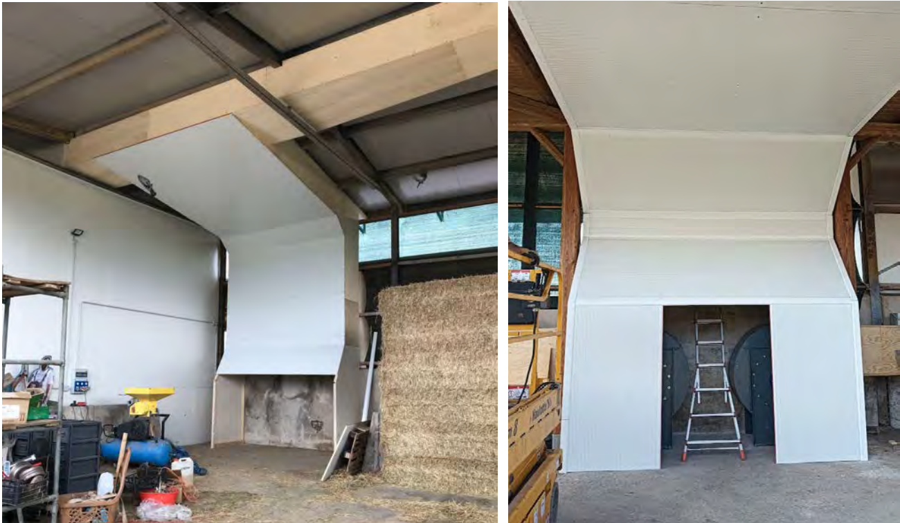
Figura 6. Collettore di aria calda sul colmo del tetto (figura a sinistra) e condotta di canalizzazione dell'aria (figura a destra)
