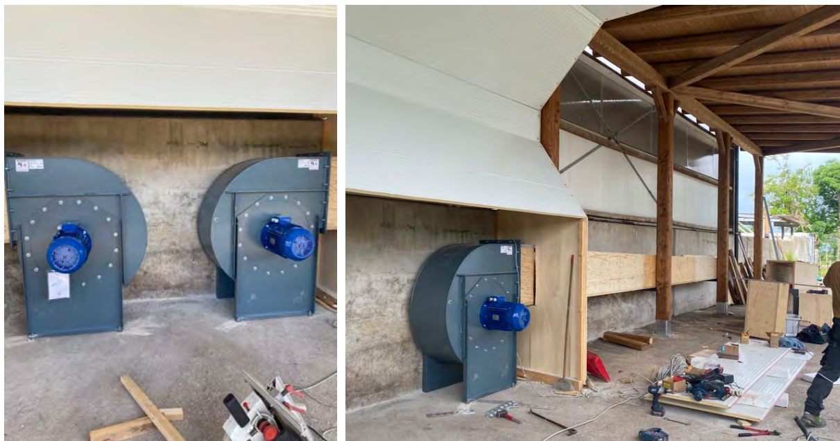
Figura 7. Ventilatori radiali per l'aspirazione e il convogliamento dell'aria calda (figura a sinistra) e ventilatore con struttura per la canalizzazione dell'aria verso le piattaforme di distribuzione (figura a destra)
