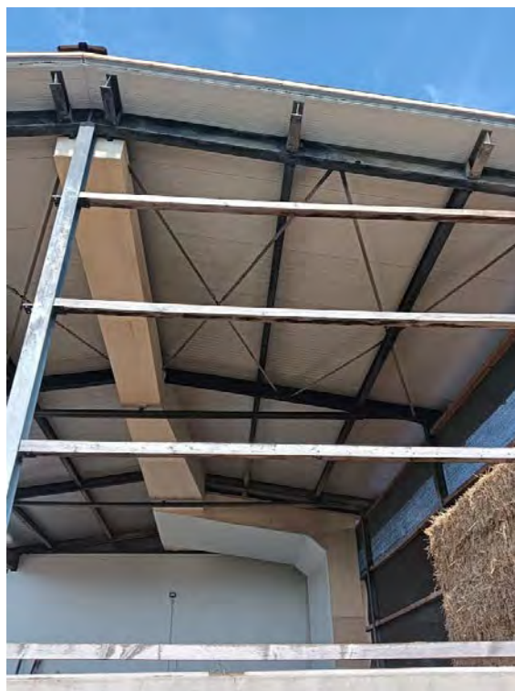
Dettaglio della fase di realizzazione della copertura della struttura per l'essiccazione delle rotoballe composta da intercapedine per il riscaldamento mediante irraggiamento solare e da condotte di invio dell'aria riscaldata verso le pompe di distribuzione.
