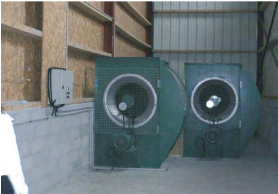
Figura 3. Ventilatore radiale per l'insufflaggio dell'aria calda
